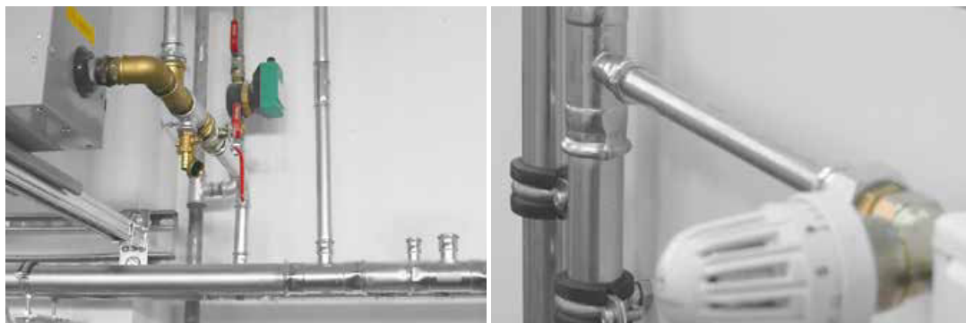
Przykłady instalacji KAN-therm Steel
